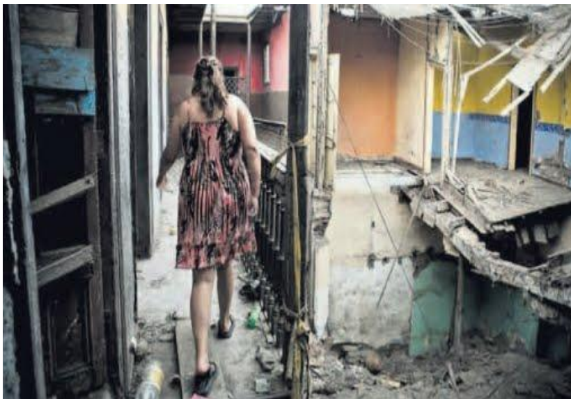
Figura N° 37.- imágenes de condiciones de precariedad y peligro en el Centro Histórico, zona A del distrito del Rímac.
