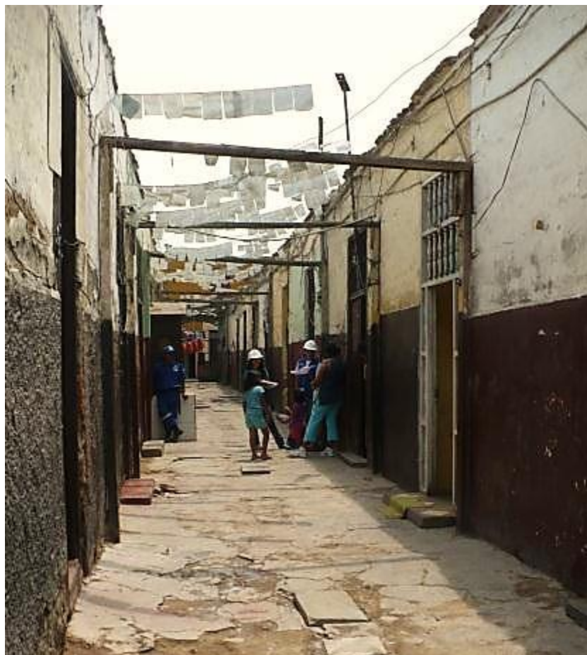
Figura N° 34.- Imagen de precariedad y la necesidad de incorporar estrategias de renovación urbana, acondicionamiento y acciones correctivas de gestión de riesgo de desastres.
